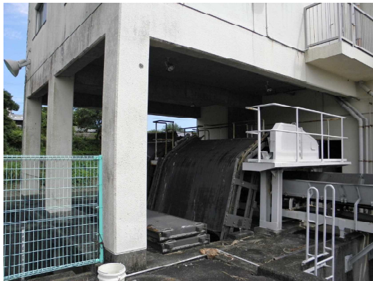
写真2.4：除塵機と水平コンベア
