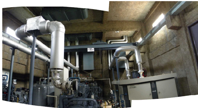
写真2.6：建屋内ポンプ設備
